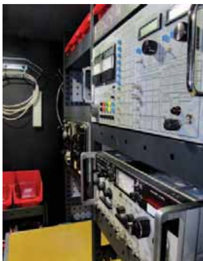
Stanowisko sprawdzeń radarów pogodowych.
