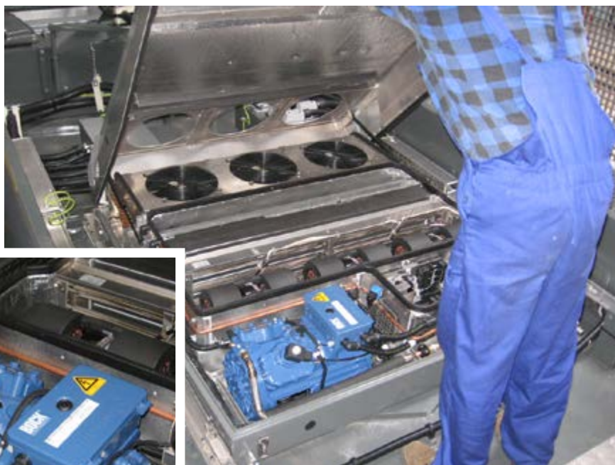
Sprawdzeń klimatyzacji dokonujemy zgodnie z planami konserwacji producenta w zależności od typu urządzenia.
