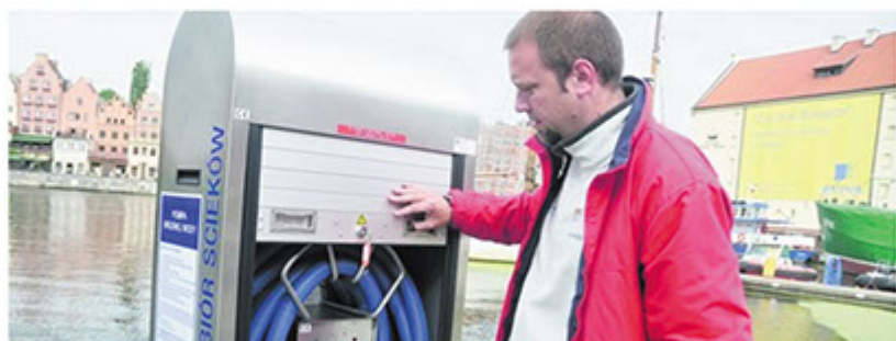
Kierownik Mariny Gdańsk, pan Rafał Grad (na zdj.) podkreśla, że instalacja pompy do odbioru ścieków to kolejny krok w dostosowaniu mariny do standardów i wymogów ekologicznego programu europejskiego Błękitna Flaga.
